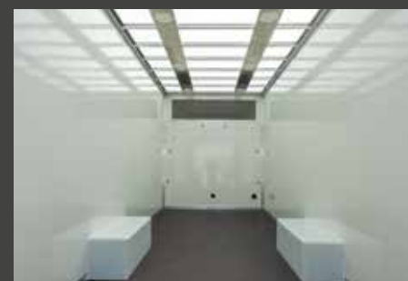
translucentní stropní panel
